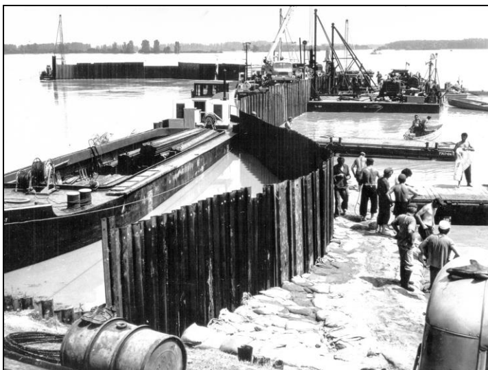
A gátszakadás lezárása
